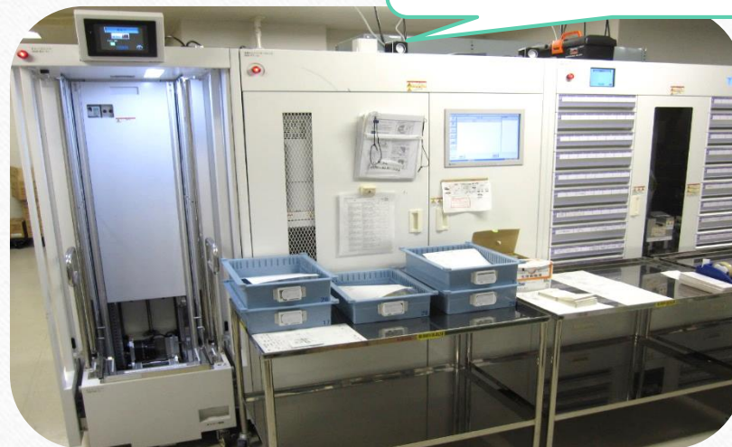
注射薬自動払出システム
